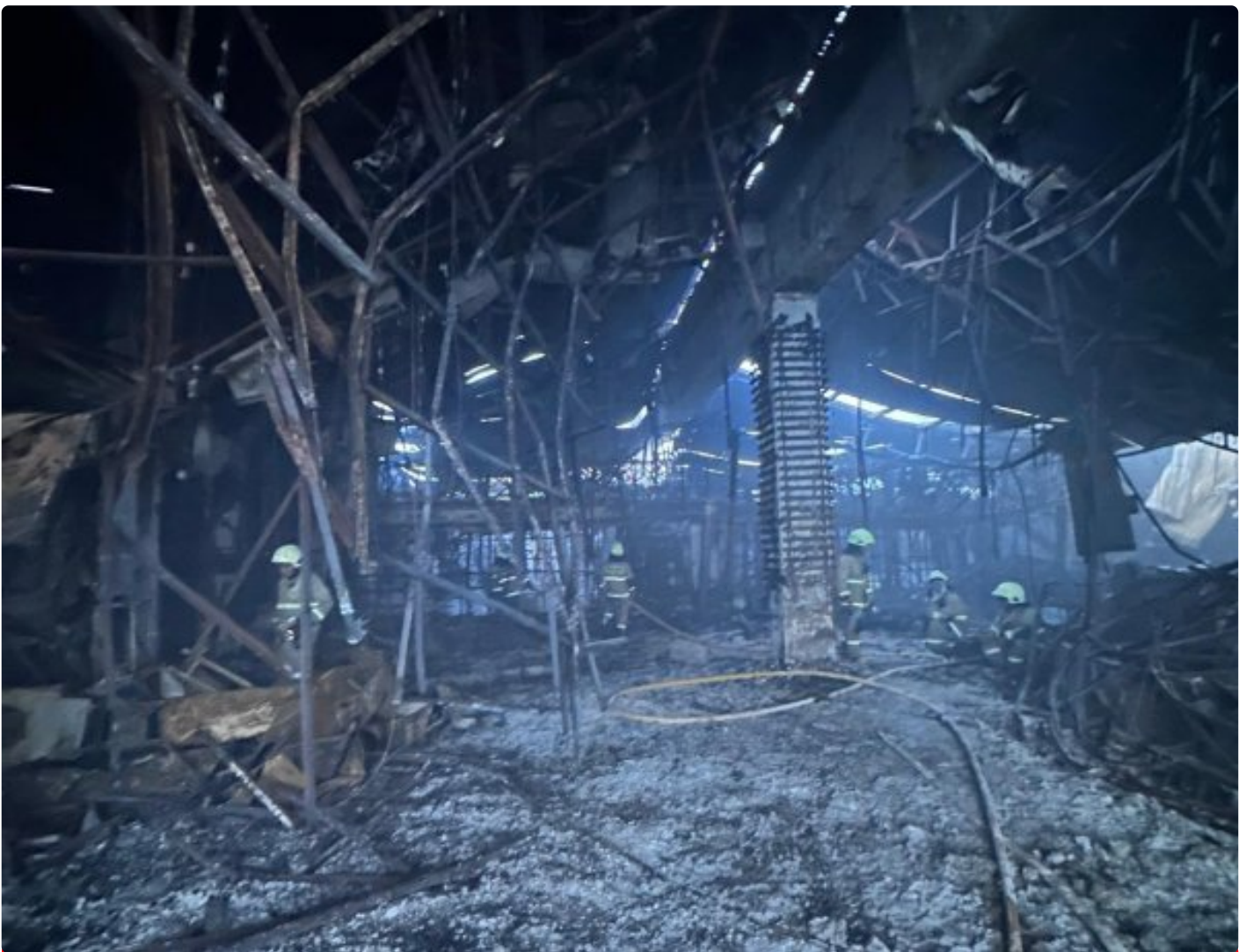
Glodok Plaza yang Hangus Terbakar
